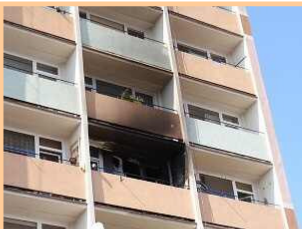
Požárem poškozený balkon narušil vzhled celého domu.
